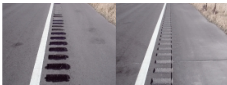
導水溝無し 導水溝有り 写真 - 8 降雪翌日の状況（平成14年3月1日）
