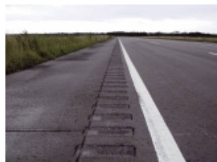
写真 - 6 導水溝を付加した路肩のランブルストリップ
