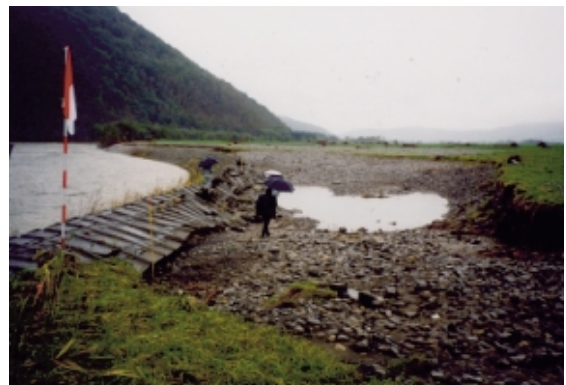
写真－3 渚滑川・高水敷の洗掘状況(1)
