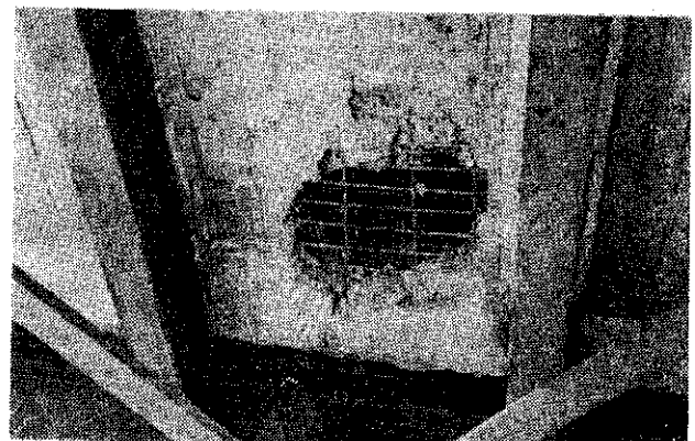
写真—9 損 傷 ラ ン ク 8
