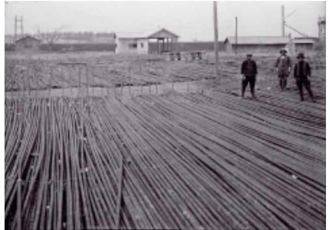
写真 - 5 鉄筋の彎曲状況
